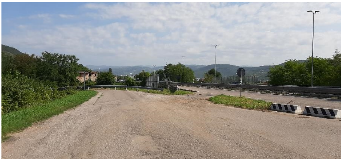
Figura 14 - Sbocco di via del Sasso sulla controstrada. In primo piano il margine stradale attuale sconnesso.
